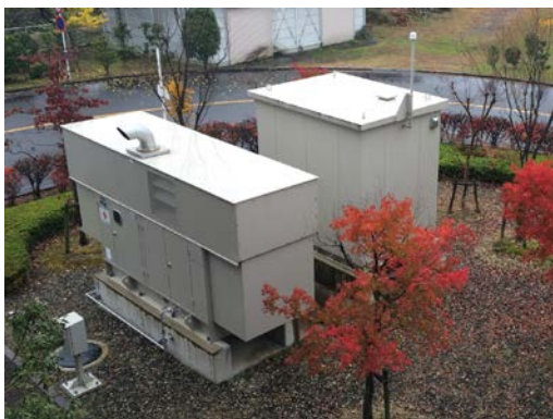
写真-18 発電設備の例 (湖南広域行政組合 環境衛生センター)
