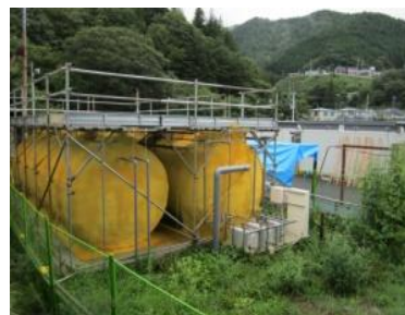
写真-13 仮設住宅の浄化槽 (釜石市)
